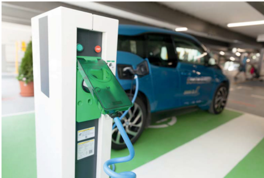
Bild 1: Ladestationen sind für die E-Mobilität unerlässlich, bei deren Installation in Garagen ist jedoch das erhöhte Brandrisiko von Elektrofahrzeugen während des Ladens zu beachten. ©FOGTEC Brandschutz GmbH
